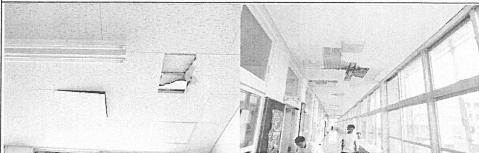
雨漏りによる教室や廊下の天井ボード破損
