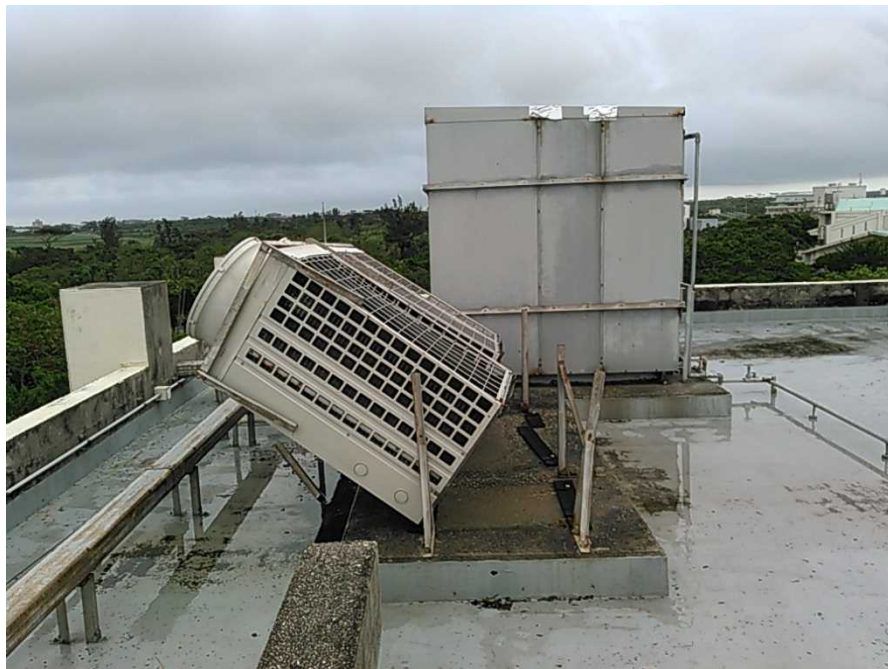
固定金具が破損し転倒した。
