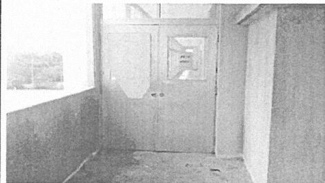
出入り口戸ガラス破損
