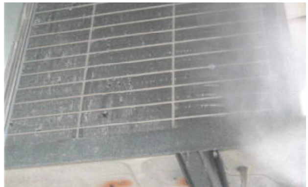
室外機熱交換器の腐食劣化状況
